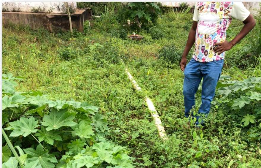
Tubulação sanitária exposta
