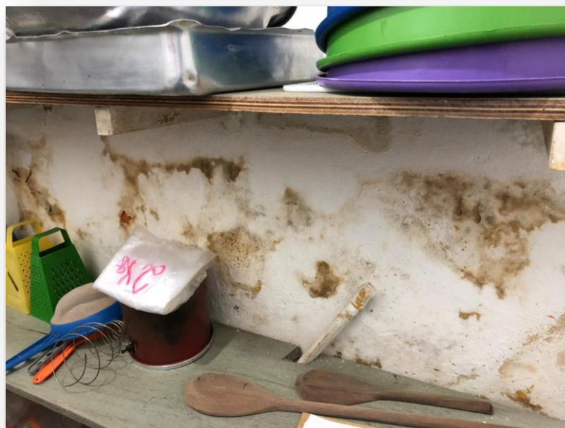
Revestimento a recuperar
