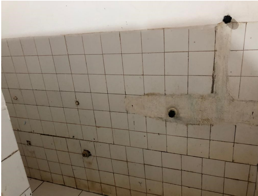
Banheiro – Instalações a recuperar
