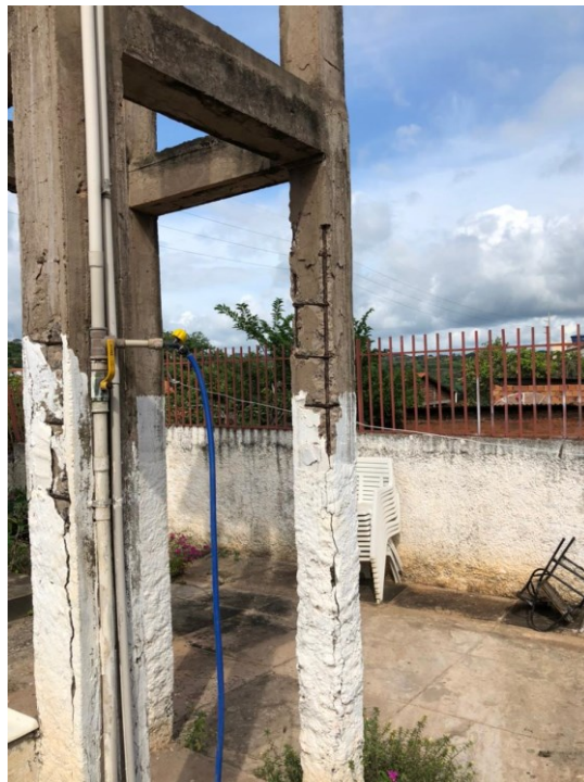
Estrutura da Caixa D'água a recuperar
