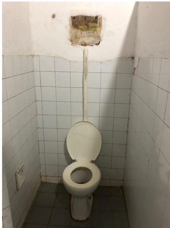
Banheiro – Bacia Sanitária sem Caixa de descarga
